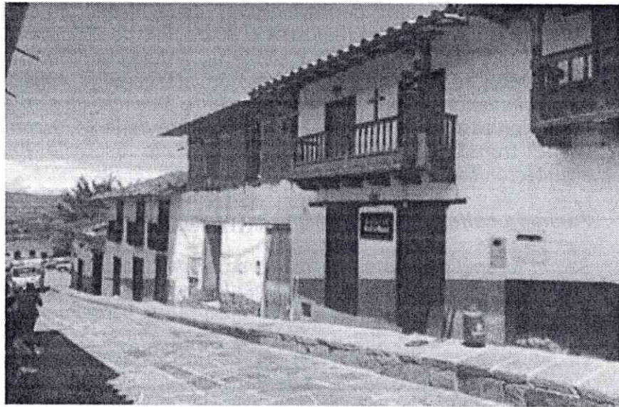
Imagen 8. Fotografía de las obras en ejecución. Señalada con línea roja segmentada la altura aproximada que debería tener la cubierta. Fuente: visita técnica realizada el 30 de julio de 2025.
