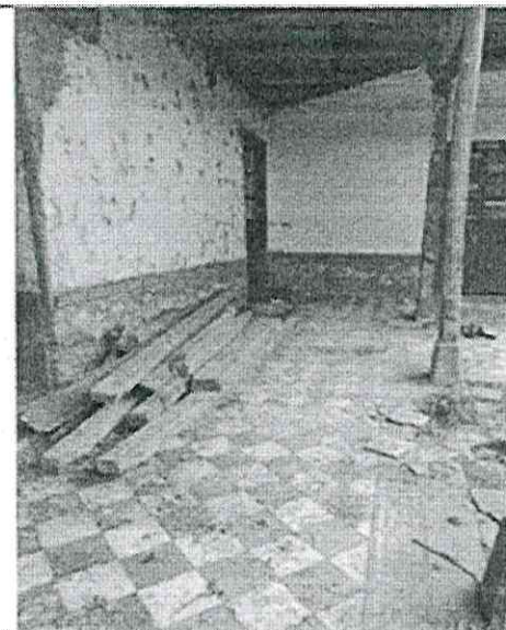
Fotografía 11. Los pisos también hacen parte de este mismo panorama: fracturados, con asentamientos, excavaciones para introducir tuberías sanitarias o realizar cajas de inspección, sin restitución de la zona y análisis de reposición sobre el bien patrimonial.
