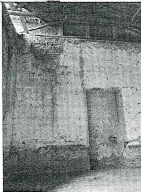
Fotografía 17. visualiza las grandes aberturas que se tienen en cubierta, permitiendo el paso de aguas hacia los muros y demás elementos.
