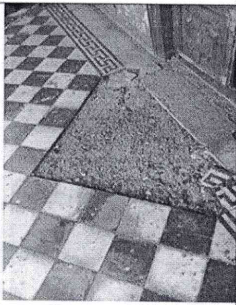
Fotografía 16. Los pisos también hacen parte de este mismo estado de daño: fracturados, con asentamientos, excavaciones para introducir tuberías sanitarias o realizar cajas, sin restitución y análisis de reposición sobre el bien patrimonial.
