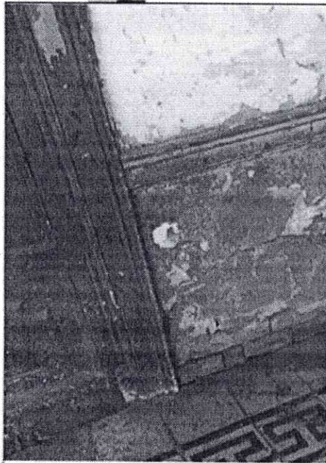
Fotografía 13. En la parte interna del inmueble, es más evidente el deterioro, los muros denotan la pérdida del acabado, pintura craquelada, con exposición del material terreo, resanes aplicados sin técnica y suciedad.
