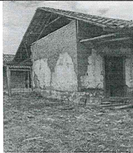
Fotografía 9. Pone de presente nuevamente aspectos de presente la intervención con los tipos de mampostería (adobe/ladrillo), sin mayor análisis técnico de dos tipos de técnicas constructiva y su comportamiento estructural, así como el daño en los soportes o columnas de los corredores.
