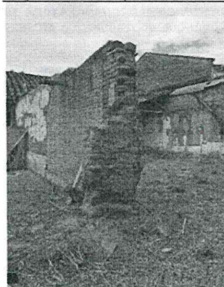
Fotografía 19. Correspondiente a la demolición de la edificación en su fondo o zona sur. Solo subsiste una parte del muro que cerraba la estancia y el muro perimetral colindante con el predio vecino: en estado de desprotección.
