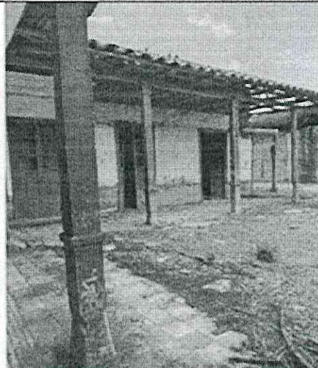
Fotografía 10. La pérdida de elementos constitutivos de las cubiertas, permite el ingreso de humedad hacia el interior del inmueble, afectando la constitución de los muros de adobe. Igualmente se ve afectado, el sistema estructural de cubierta en madera, por la exposición a la humedad, de manera permanente. Los pilares en madera de los corredores, presentan desgaste, pérdida de sección, alabeo y fractura.
