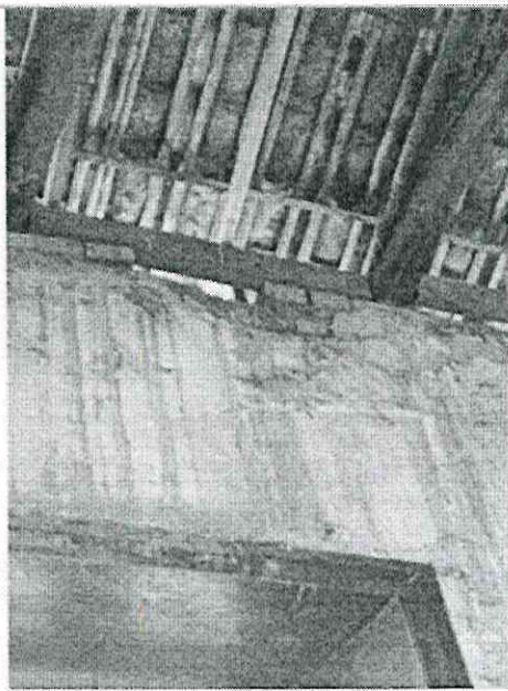
Fotografía 18. también permite inducir que se han repuesto elementos de cubierta, pero no se ha terminado el sellado muros-cubierta.
