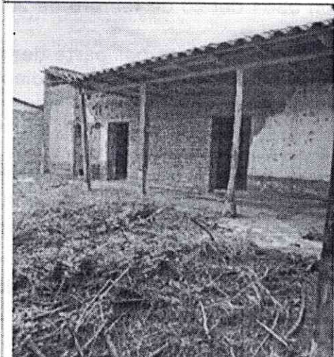
Fotografía 7. Pone de presente nuevamente aspectos de presente la intervención con los tipos de mampostería (adobe/ladrillo), sin mayor análisis técnico de dos tipos de técnicas constructiva y su comportamiento estructural, así como el daño en los soportes o columnas de los corredores.
