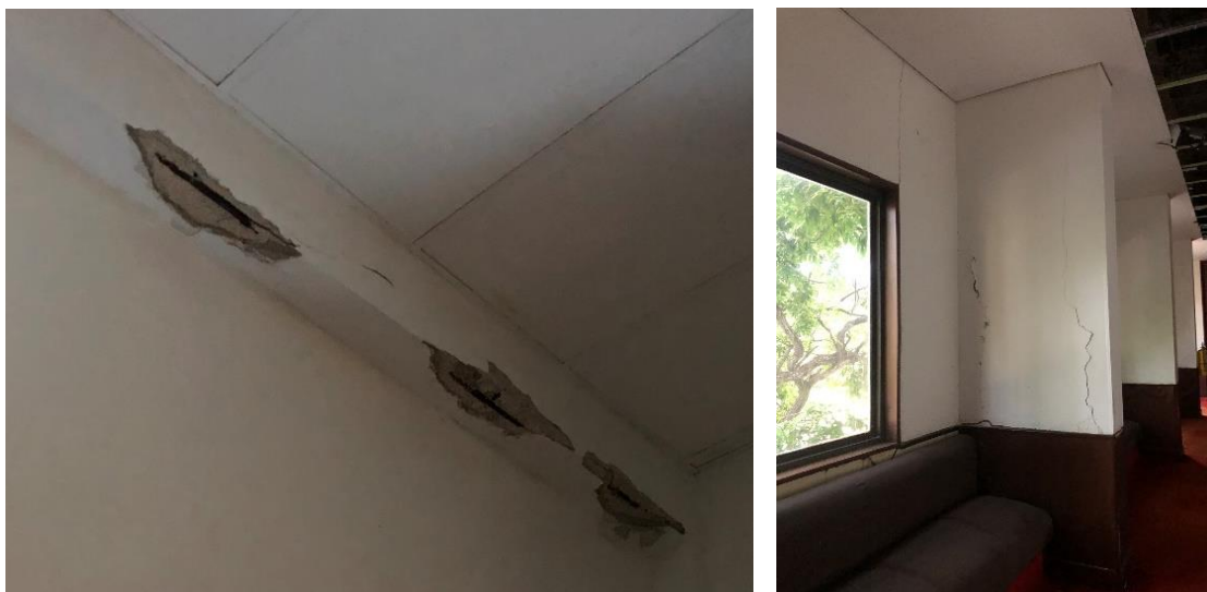
Imagen 189. Presencia de carbonatación en Viga. Presencia de fisuras en columnas.
