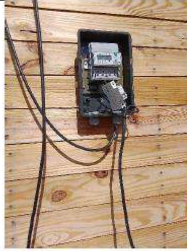
Foto No. 14 El contador y los cables fueron instalados sin ninguna protección
