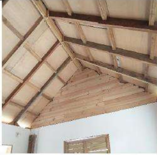
Foto No. 13 En la cubierta la tornería atravesó el total de la lámina de madera sobresale entre 1 y 2 pulg
